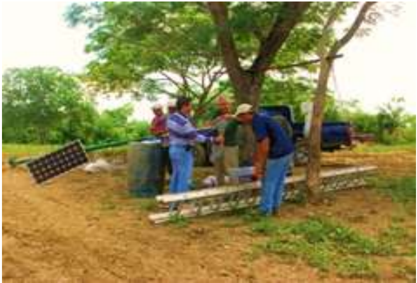
FIGURAS 50. Proceso de ensamblaje de la planta solar fotovoltaica-eólica instalada en una unidad de producción aledaña a la población de Yaracal, Municipio Caciue Manaure, Estado Falcón.
