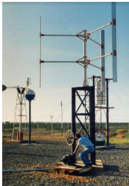
FIGURA 9. Aerogenerador Musgrove de 5 kW de potencia nominal
