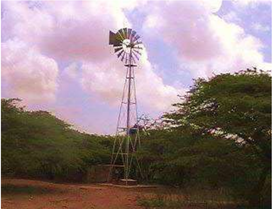
FIGURA 29. Vista Panorámica de la Aerobomba en pleno Funcionamiento extrayendo agua del pozo recuperado.
