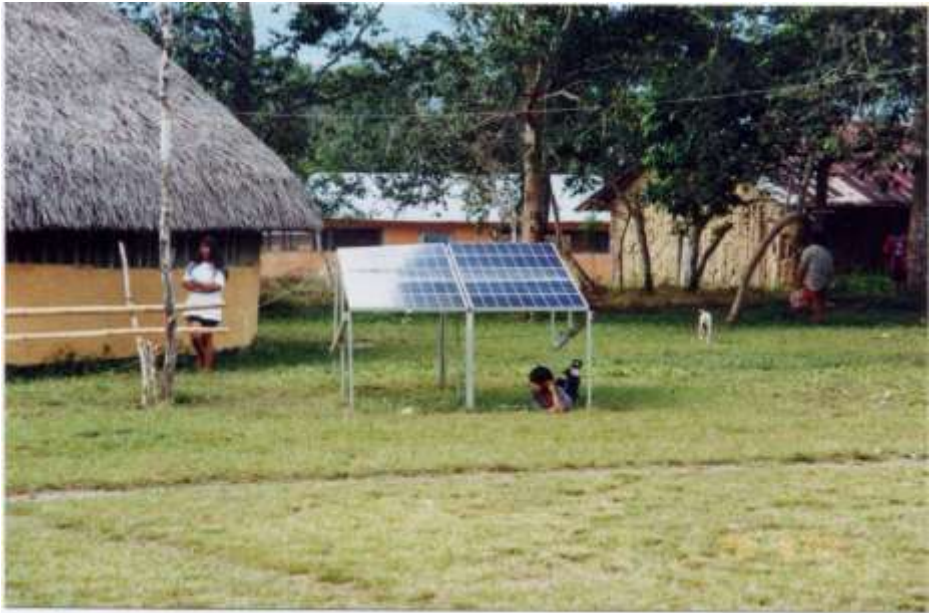
FIGURA 41. Planta de generación fotovoltaica de la estación de INPARQUES
