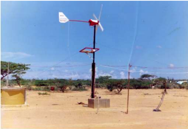
FIGURA 7. Aerogenerador Híbrido instalado en la comunidad de Jacuque
