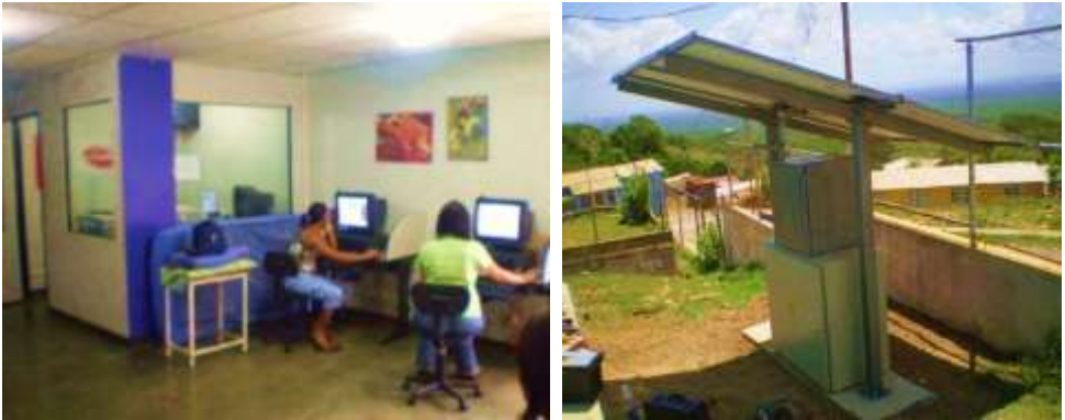
FIGURA 47 a y b. INFOCENTRO de la población de Jacura funcionando con energía eléctrica fotovoltaica.
