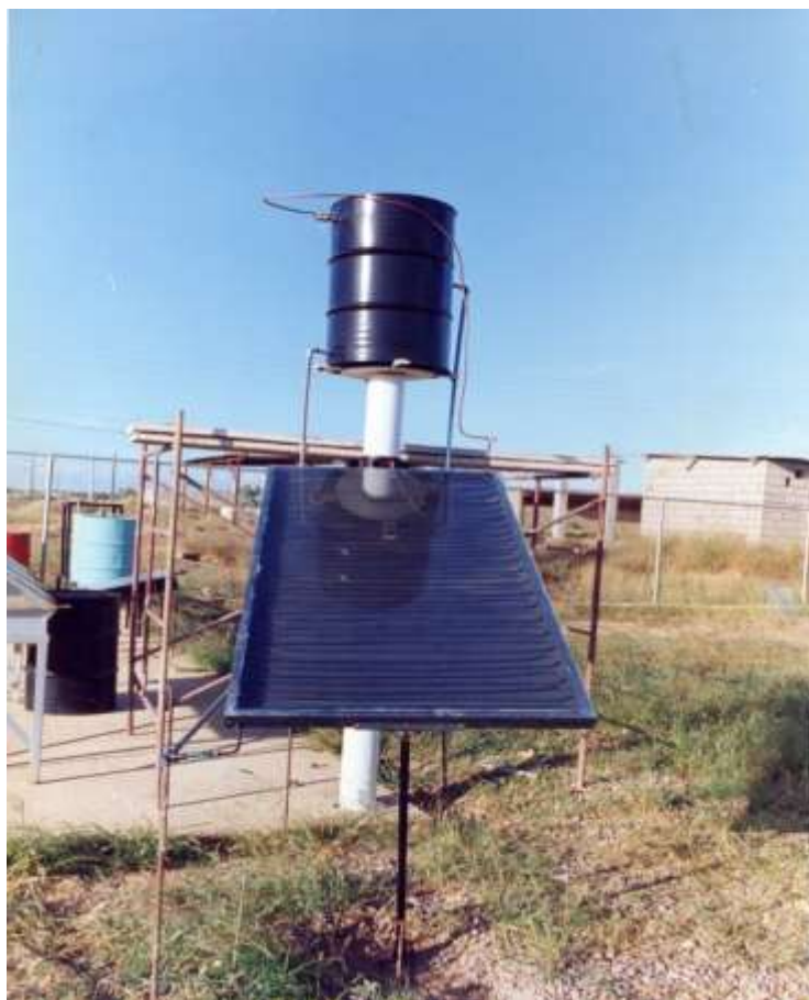
FIGURA 22. Calentador de agua con colector solar plano
