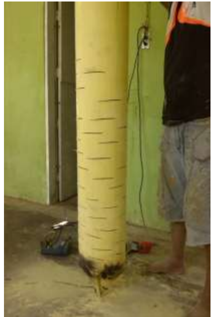
FIGURAS 54 a, b. Elaboración de camisa de filtración con punta de lápiz y ranurado de percolación, colocación de malla a la camisa filtrante para evitar la entrada de arena fina y otros elementos sólidos al interior del tubo.
