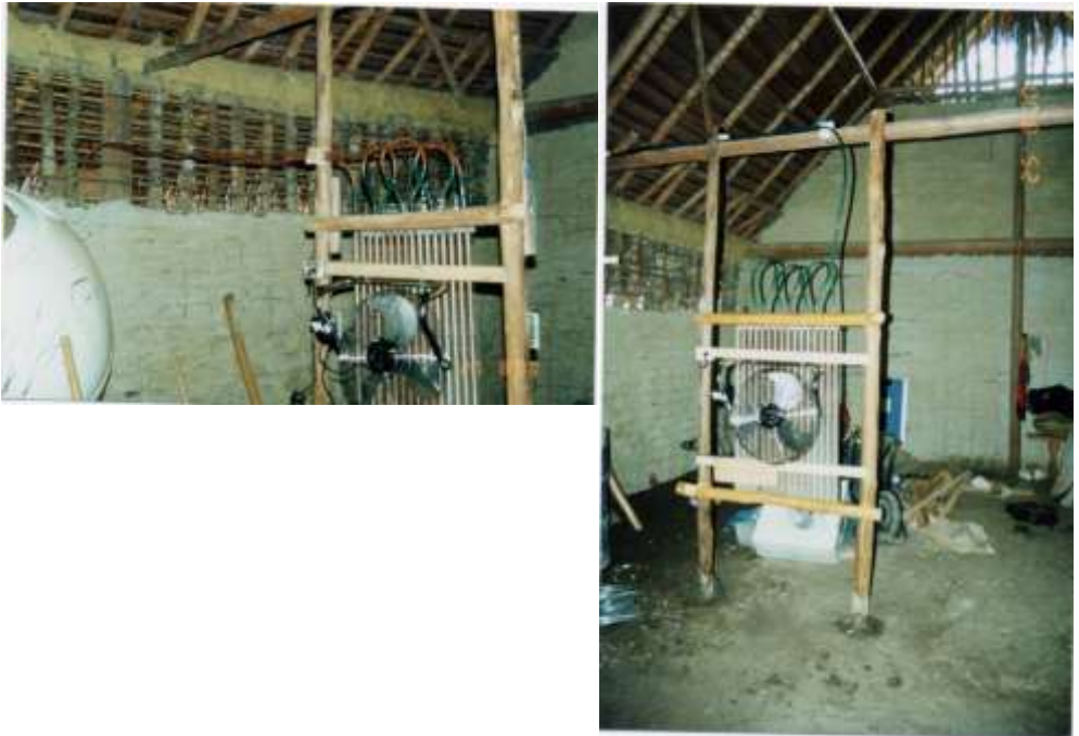
FIGURAS 40 a y b. Vista de detalle y de conjunto del sistema de climatización sala de computadoras, periféricos y GPS.
